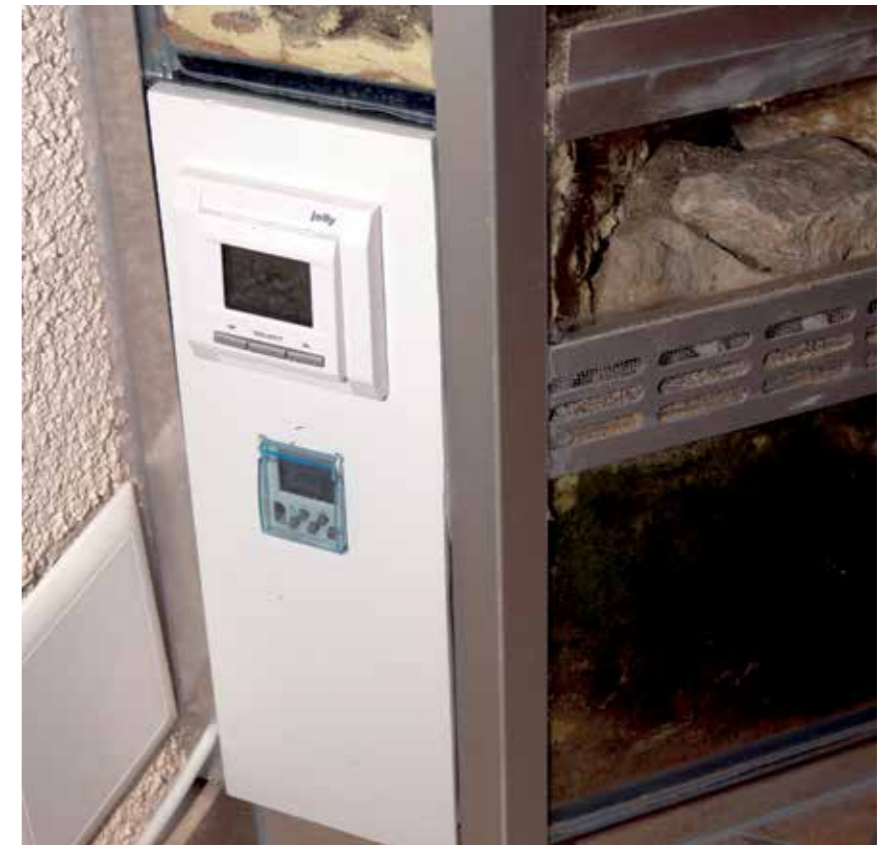
Heizung und Beleuchtung der Wintergartenterrarien werden über zwei Thermostaten und eine astronomische Schaltuhr gesteuert. Die Schaltuhr passt die Beleuchtungsdauer täglich dem aktuellen Sonnenstand an.
